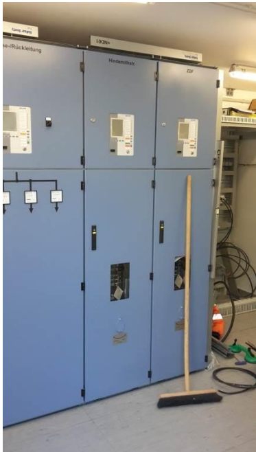
Einspeise-/RL-Feld und Streckenschalter im GUV
