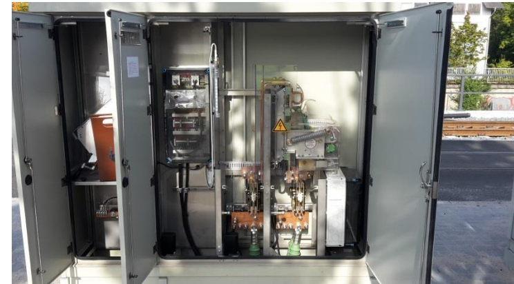
Einspeiselasttrennschalter an der Strecke
