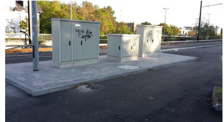
Einspeise- und Kuppelleistungsschalterschrank an der Strecke
